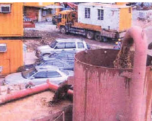
建築地盤的循環用水系統
