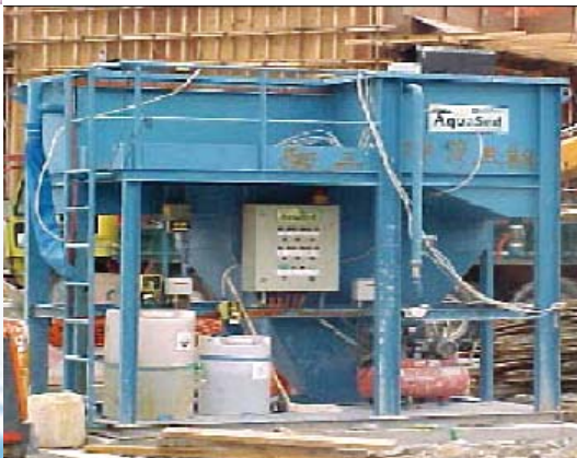
鑽樁工程所採用的廢水循環系統
