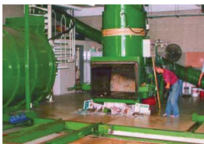
操作中的中央垃圾收集站
